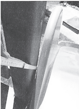
Situation: Beim Rutscheneinstieg hat es eine Kordelfangstelle. Der Rutschenauslauf ist ohne Fallschutz. Massnahme: Kordelfangstelle mit Holzleiste eliminieren (Spalt schliessen). Rutschenauslauf mit falldämpfendem Bodenbelag versehen (2.5 x 2 m).
